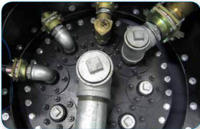
Ligações da tampa do tanque com encaixe de flange e válvulas de corte.
