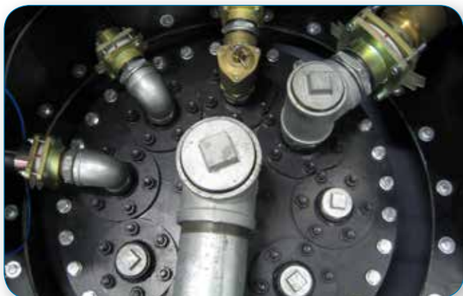
Röranslutningar till tanklocket med flänskopplingar och avstängningsventiler.
