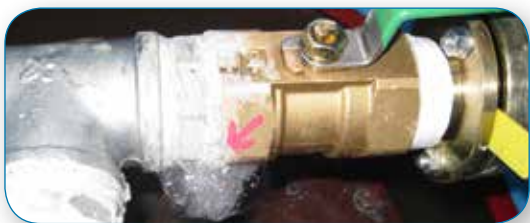
Bubblor är ett säkert tecken på läckage.
