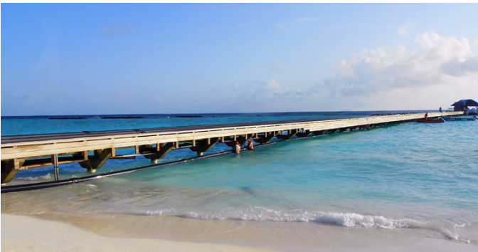
Akaryakıt teslim iskelesi: borular sürekli tuzlu suya maruz kalıyor
