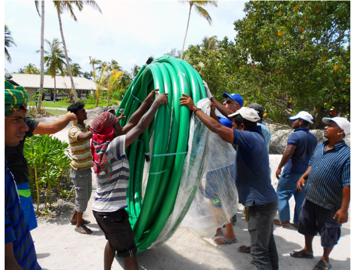
Yeni yakıt hattı için KPS 75/63SCEC çift cidarlı yakıt boru rulusunun ambalajının açılması
