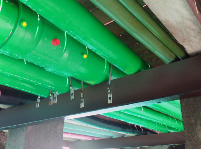
Akaryakıt hatları, gemiden depolama noktasına iskelenin altından geçiyor
