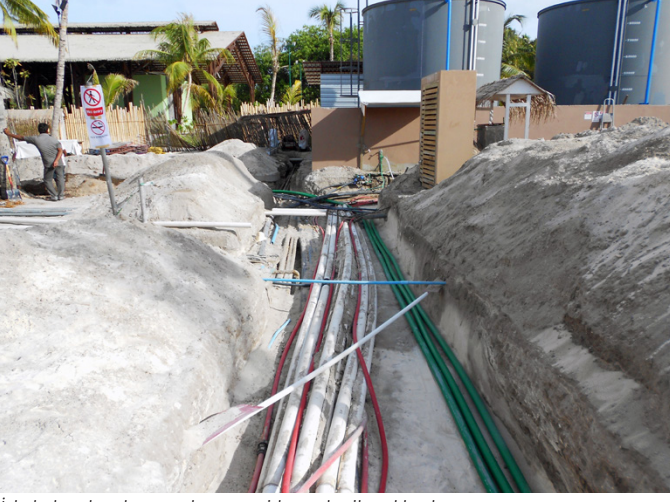
İskeleden depolama noktasına giden yakıt ikmal hatları
