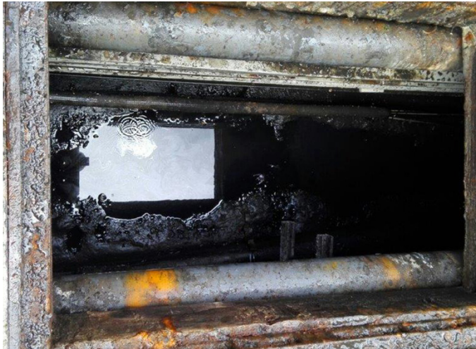
DPaslanma nedeniyle borularda aşınma ve bozulma meydana gelmiştir
