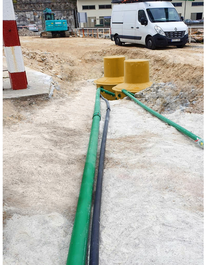
İletken borular, yakıt akışından kaynaklanan statik elektrik oluşumunu engeller
